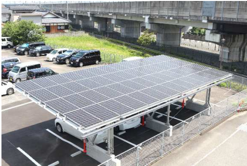
太陽光パネル付きカーポート 太陽光パネル56枚 11.6kW
